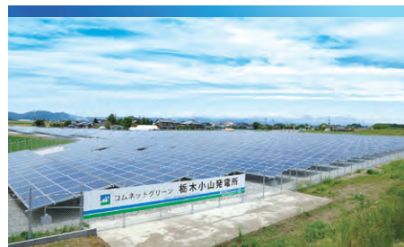
コムネットグリーン栃木小山発電所は、白鷗大学野球場跡地(27,339㎡)を利用しています。
